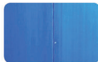
PE 부력키 설치로 녹발생 없음
